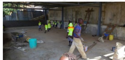
Rohbau der 3 Klassenzimmer. Viel Platz und Licht als ideale Bedingungen für guten Unterricht für unsere Erst- bis Drittklässler.
